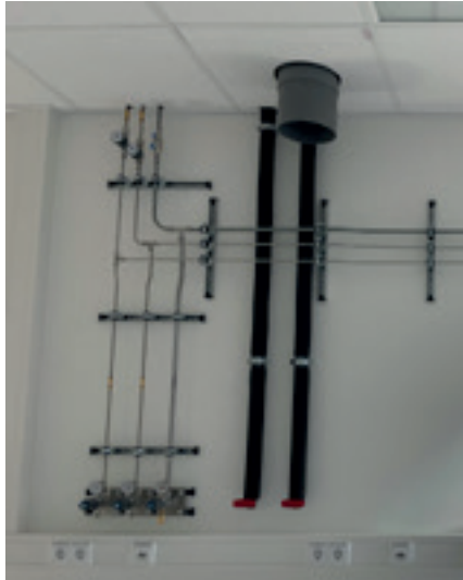
Techn. Anschlüsse im Labor
